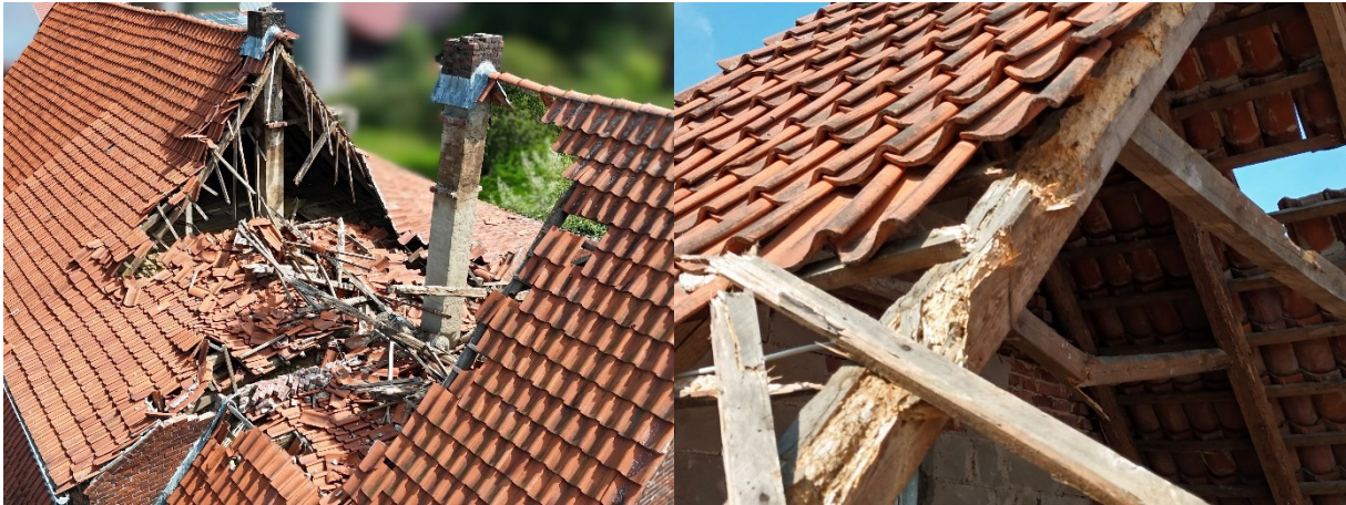
Bild 2: Schaden am Dachstuhl durch den Hausbockkäfer
